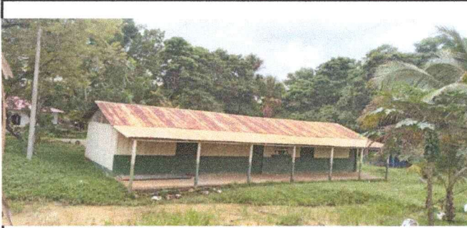
Foto1: MODULO 2 Cambio de laminas por lo que se ve esta deteriorados y oxidados
